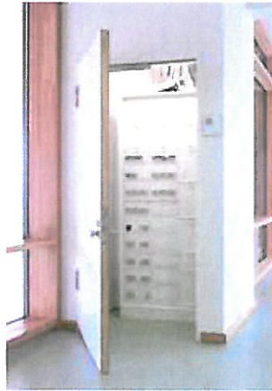
Verschluss-sache: Die Hager-Verteilungen verrichten ihren Dienst zuverlässig im Hintergrund.
