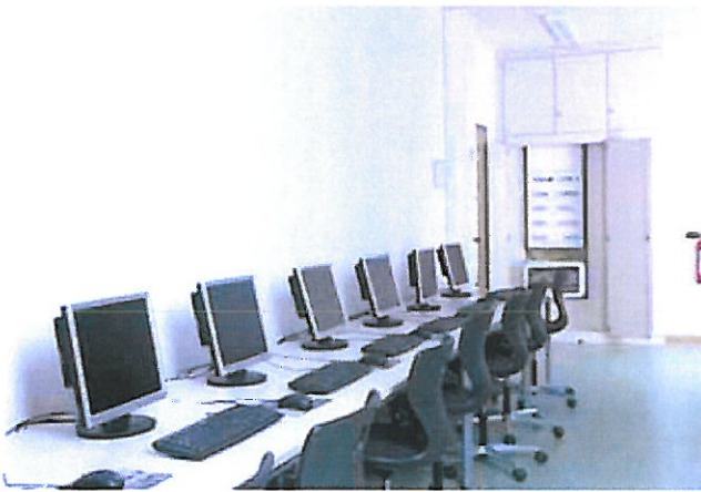
Unsichtbare Anschluss-technik: Die Zuführung der Datenleitungen im EDV-Raum erfolgt aus dem Unterflurbereich. Die Anschlüsse stellen Tehalit-Kabelaussätze bereit.
