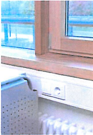
Tehalit-BR-netway-Brüstungskanäle stellen die Anschluss-technik für einen modernen Schulbetrieb sicher.
