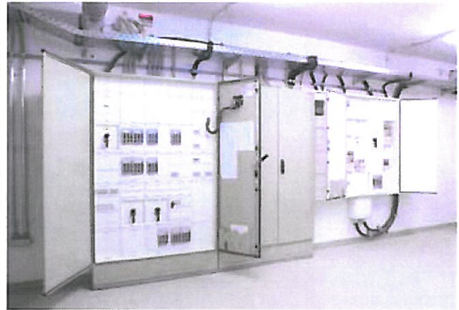
In der Hager-Niederspannungshauptverteilung sind die modularen Schutz- und Schaltgeräte ebenso untergebracht wie die 250 A Wandleranlage.
